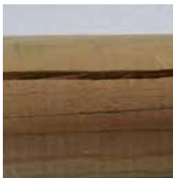
Cracks/Grietas/Fente/Risse/ Crepe/ Barsten/Fendas
