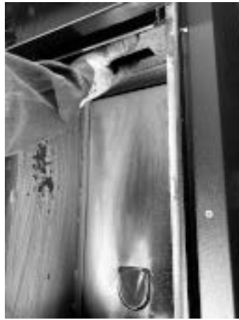
Fig. 77 - Die Stirnseite des Feuerraums 1 entfernen
