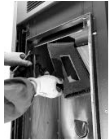
Fig. 78 - Die Stirnseite des Feuerraums 2 entfernen
