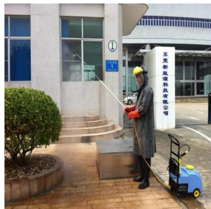
图片 2 水雾灭火器 (穿着 PPE 防止触电)
