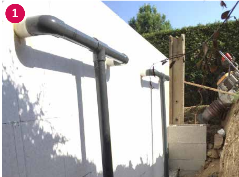
▲ Verrohrung von 4-Düsen
