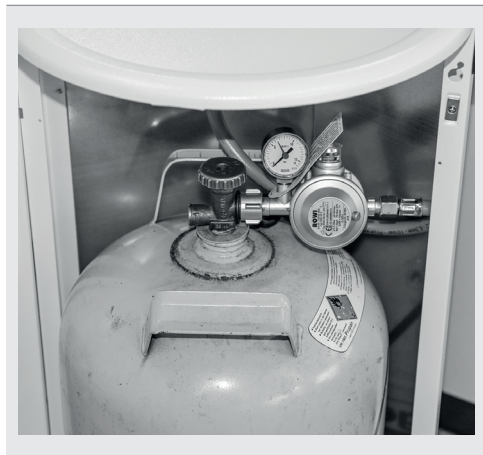
Abb.3: Installation der Gasflasche
