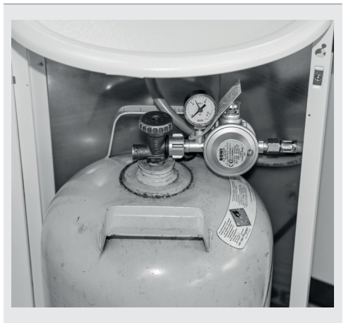
Abb.3: Installation der Gasflasche
