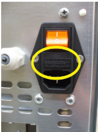
Fig. 88 - Abdeckklappe mit Sicherungen, die ausgetauscht werden müssen
