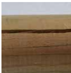
Cracks/Grietas/Fente/Risse/ Crepe/ Barsten/Fendas
