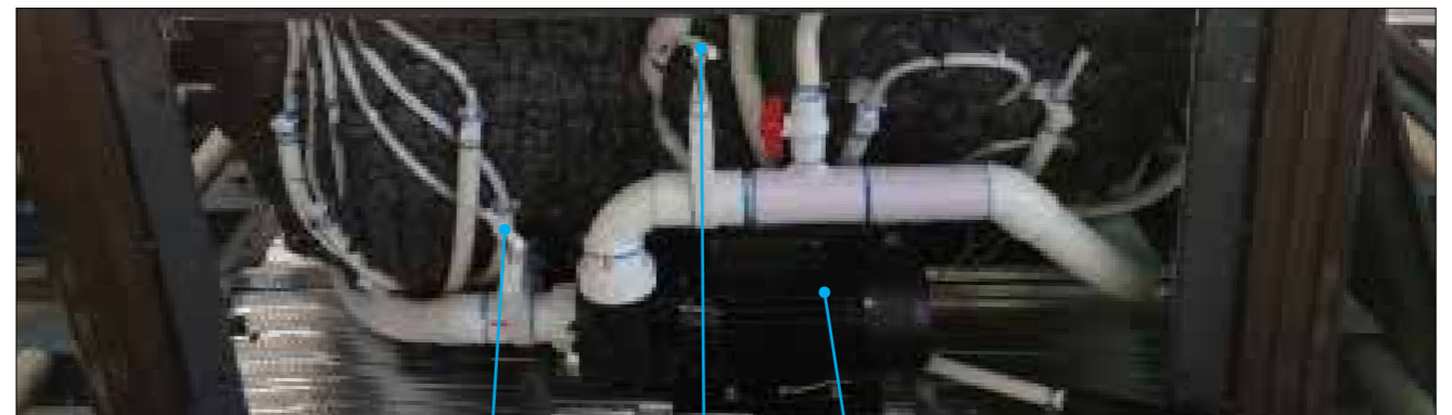
Schieberventil Schieberventil Pumpe
