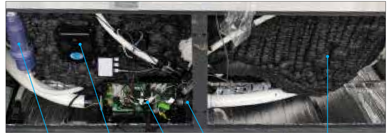
Ozon-Mischkammer Ozongenerator Steuerung Heizung Verdunkelung Isolierung
