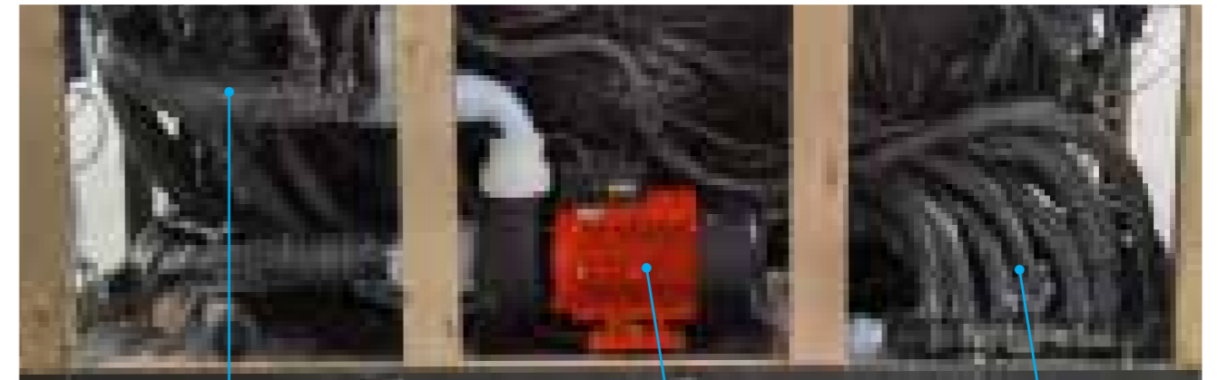
Verdunkelungsisolierung Pumpe Verteiler
