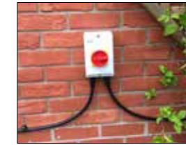
Dreh-Trennschalter (abgebildet). Stellen Sie sicher, dass Sie die Elektrik von einem qualifizierten Elektriker vorbereiten lassen. Lassen Sie 5 Meter Spielraum für den Anschluss an den Whirlpool.
