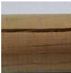
Cracks/Grietas/Fente/Risse/ Crepe/ Barsten/Fendas
