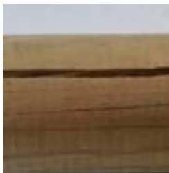
Cracks/Grietas/Fente/Risse/ Crepe/ Barsten/Fendas
