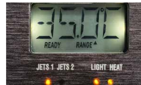
Jets 1 Licht Heizung
